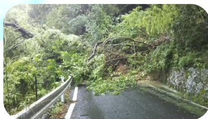
7月豪雨による土砂崩れ (H30)
